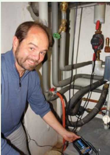
Horst Billes mit seinem Wärme-Smart-Meter
