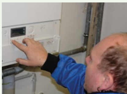
Schritt 4: Neueinstellung der Heizungsregelung
