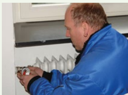
Schritt 2: Ggf. Austausch und Einstellung der Ventile durch den Handwerker und Austausch der Pumpe
